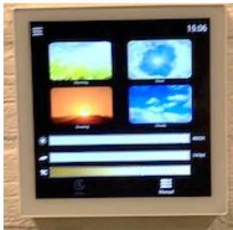
専用コントロールパネルの操作画面
